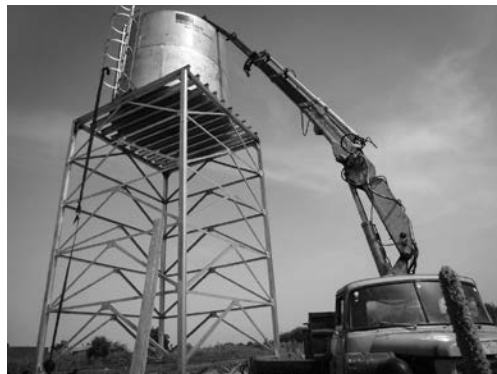
Travail dans des conditions difficiles : installation d'un réservoir et d'une pompe dans le Sahel.
